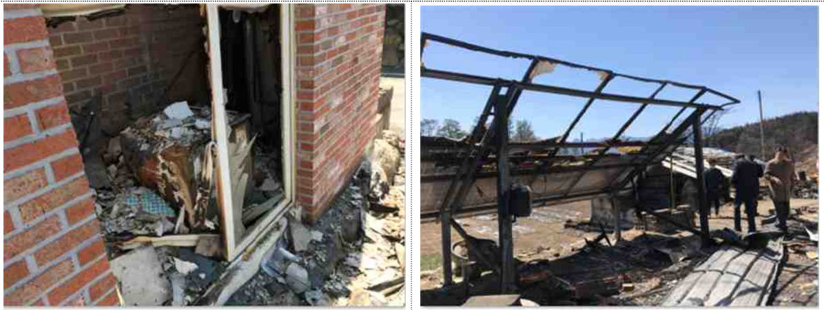
전소된 지열 히트펌프, 태양광 모듈
